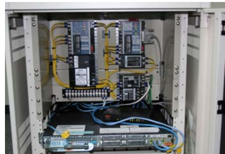
【BX-Office設置状態】
