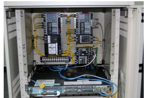
【BX-Office設置状態】
