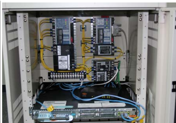
<BX-Office 設置状態>
